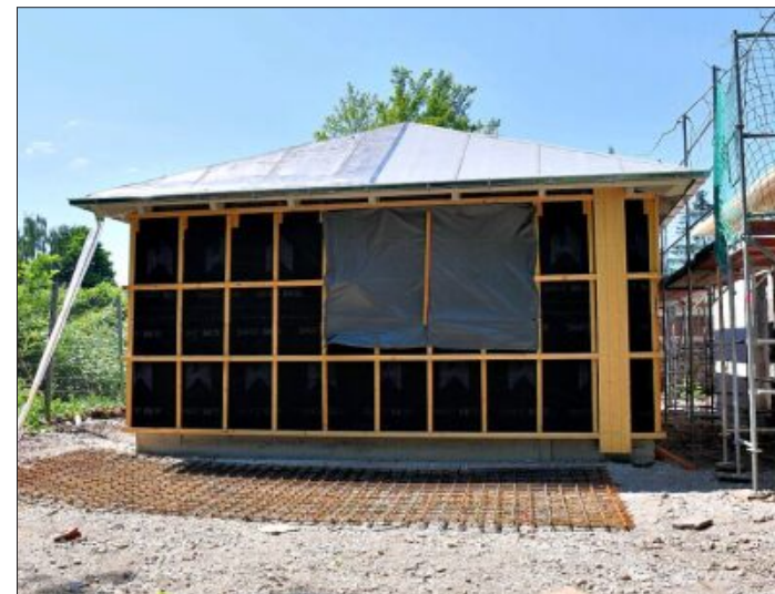
Der Pavillon für den geplanten Biergarten ist im Bau. Die Eröffnung ist aktuell für August geplant. Später folgt eine Mikrobrauerei.
